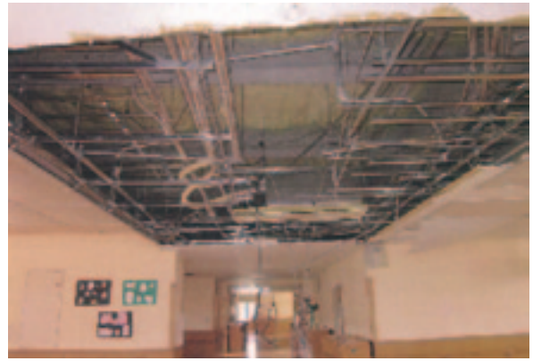
被災直後の状況 食堂の天井パネルの落下 ※
