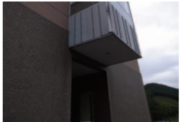
外壁の損傷 パネルのへこみは流されてきた車によるもの
