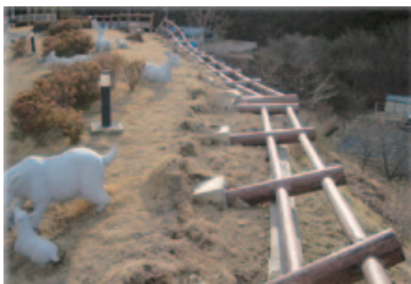
被災時の外構部分の手すりの状況 ※
