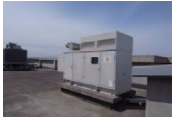
屋上設置の非常用発電機 コンセントにも通電
