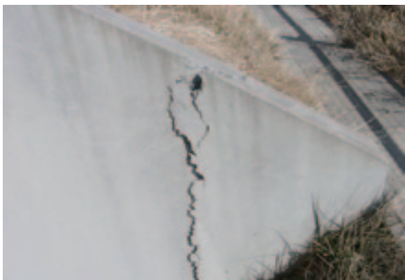
土止め擁壁のクラック ※
