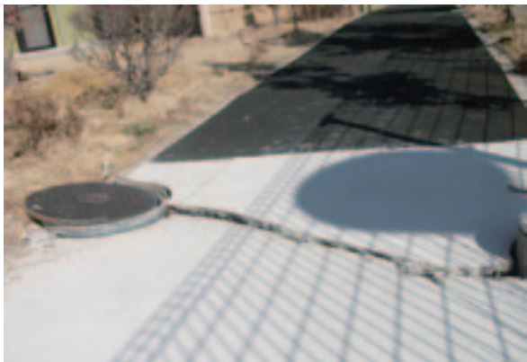
中庭の通路部分に段差が発生、舗装に亀裂 ※
