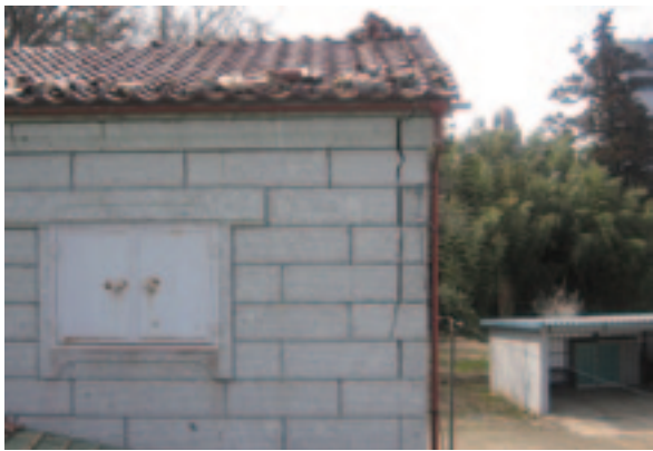
地震により被害を受けた倉 ※
