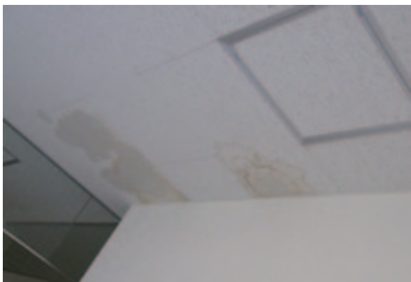
天井 外壁に未修理部分があり雨漏りが進行
