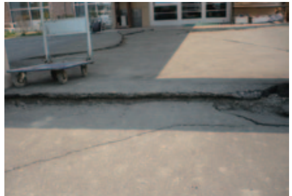
建物に損傷はなかったが、外部と建物の接点で、断裂 ※
