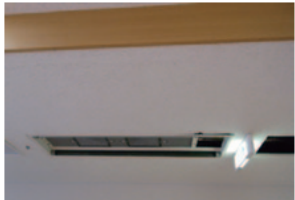
空調機器の脱落 天井の破損※
