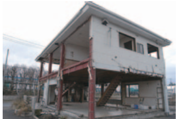
隣地にある運営者の自宅（鉄骨造）も、同様に1階の壁は流されて消失している
