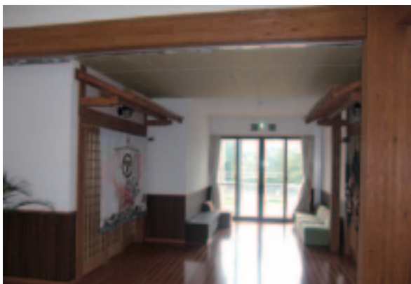
ユニット部分で一部天井落下
