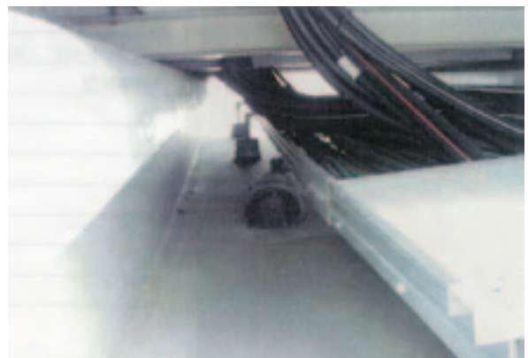
屋上ケーブルラックの損傷 ※
