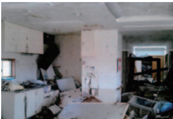
津波にあった施設（村伝さいち）の共用部分※
