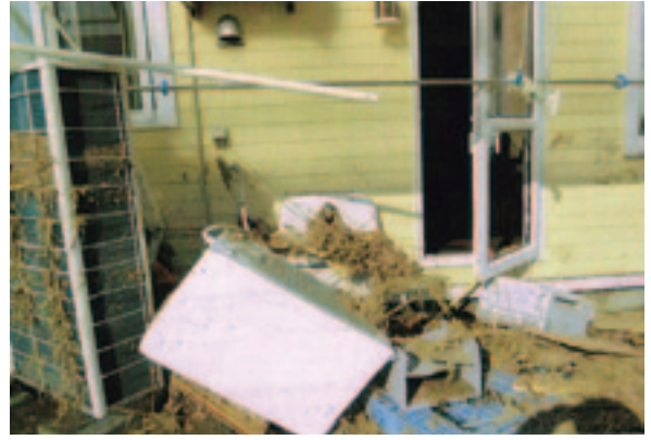
被災直後の状況 南側物干し場 ※
