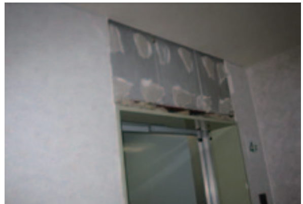
地震によりエレベータ上部の幕板ボードが落下
