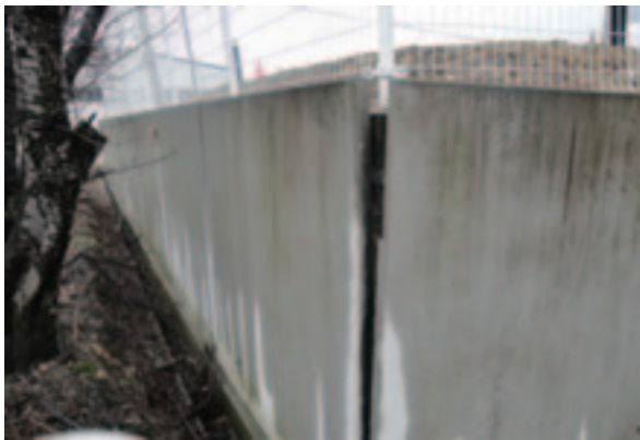
外構の破損 擁壁のコンクリート角部分のずれ※
