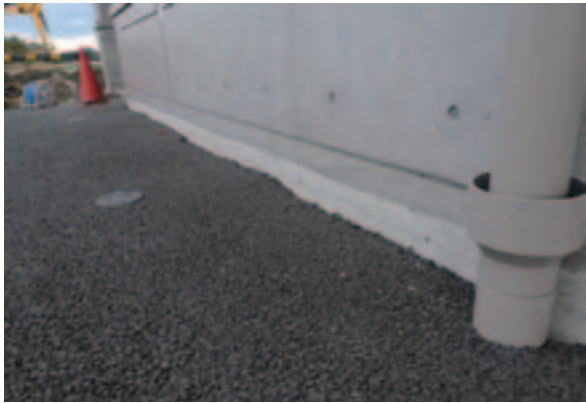
入口回り 建物に比べて地盤が沈下
