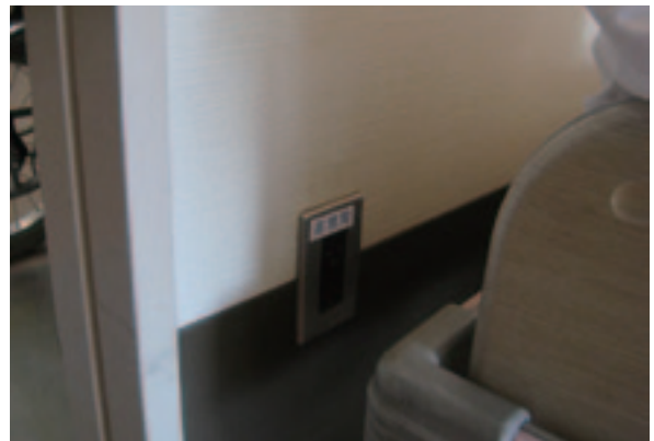
非常用コンセント 各居室に1か所
