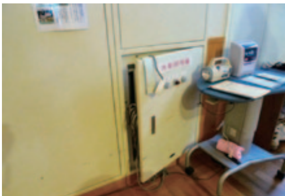
震災時唯一確保されていた非常用電源（分電盤を改造）
