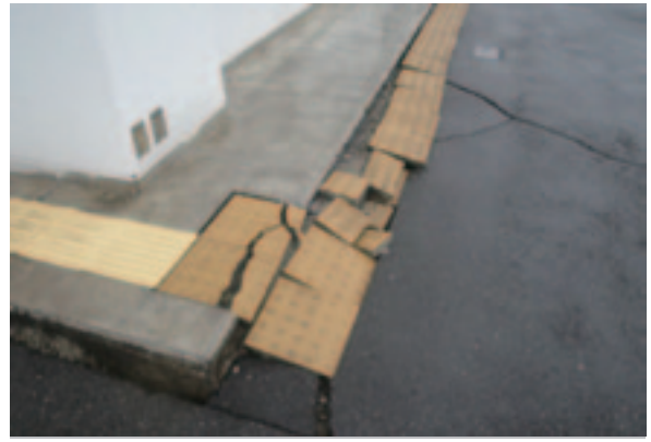
外構の破損 地盤沈下による誘導ブロックのくずれ※
