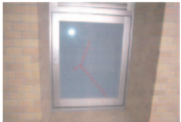
仮眠室のガラスの割れ
