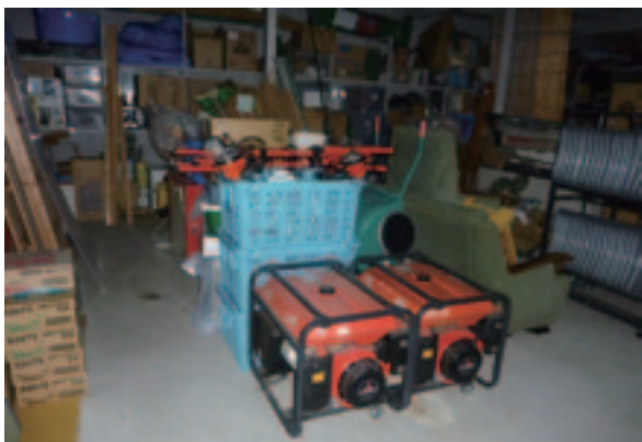
ポータブル発電機2機（倉庫内）
