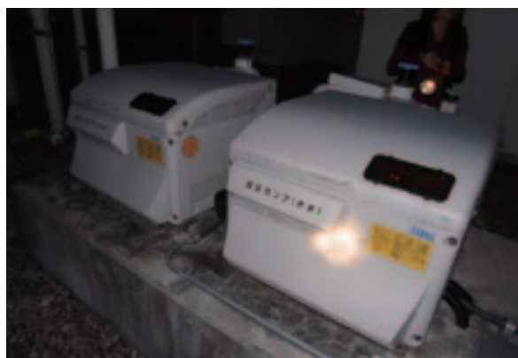
井水の濾過装置
