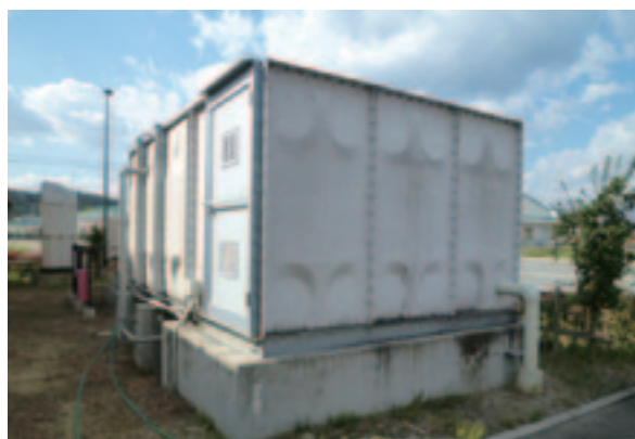
水漏れをおこした受水槽
