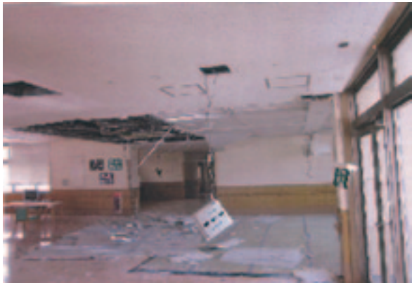
被災直後の状況 食堂の天井パネルの落下 ※
