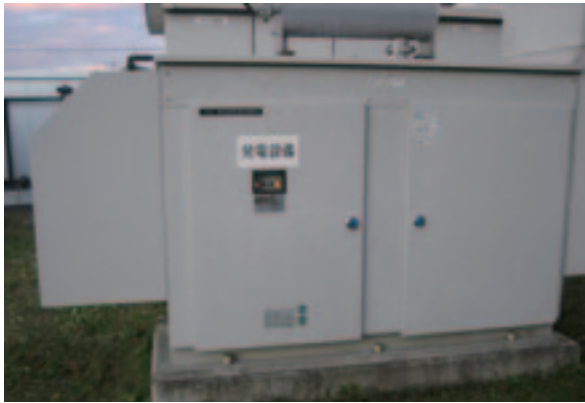
発電機（定格出力 60 KVA）
