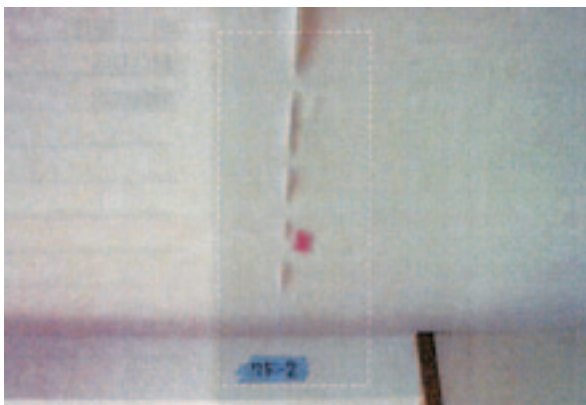
天井クロス被害 ※
