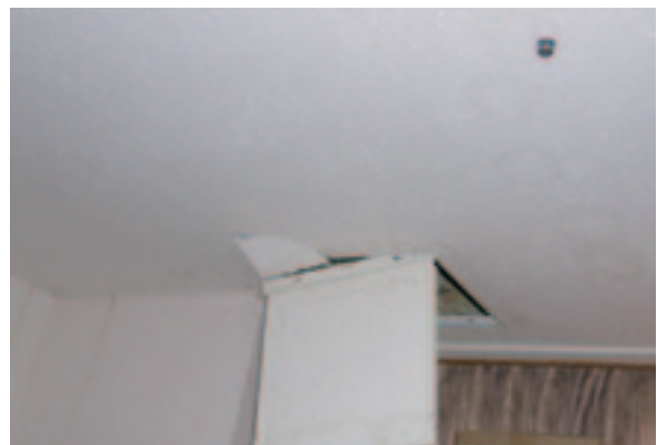
パネルヒーター配管からの水漏れ 居室は使用不可※
