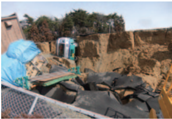
大規模な地盤被害により電気設備等も被害 ※
