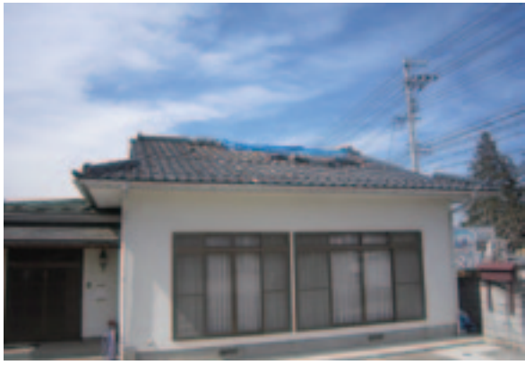
屋根瓦の被害 ※
