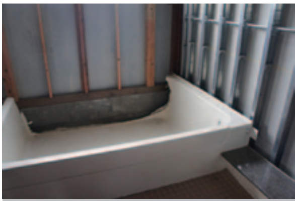
浴槽 津波により割れる
