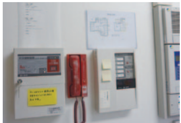
災害連絡機器と避難経路・防災訓練の表示
