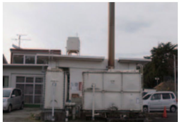
受水槽はひび割れにより水漏れ
