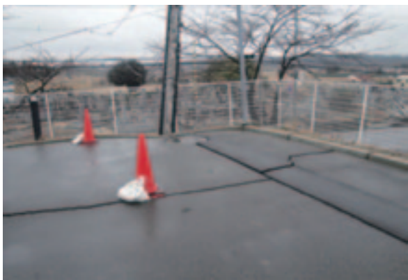
外構の破損 アスファルト面のクラック※
