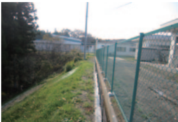
敷地周辺 土盛り部分が崩れる
