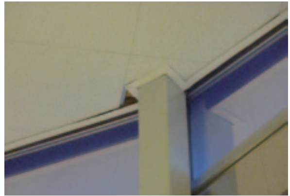
食堂天井の破損部分（20cm 角程度の天井材が落下）
