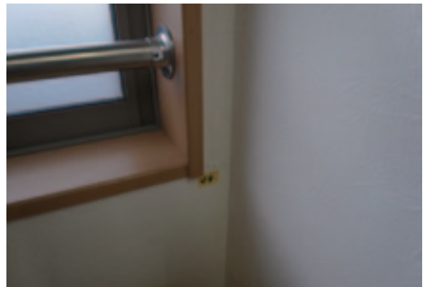
建物内に生じたクロス等の損傷 2
