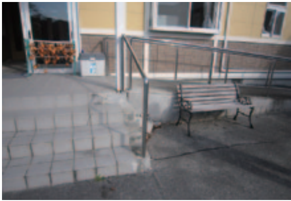
玄関 階段に亀裂が入る
