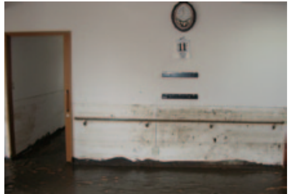
建物内は約1.2mの浸水高 ※
