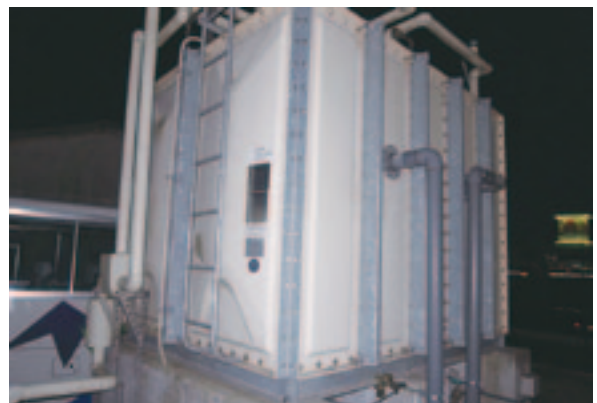
屋外受水槽（津波で海水流入して飲用水として利用できず）
