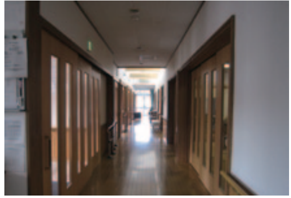
内観 クロスにひび割れ
