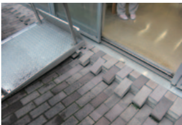
地盤沈下したベランダ
