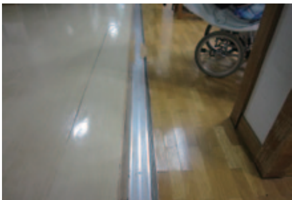
食堂と廊下に一部段差が生じる
