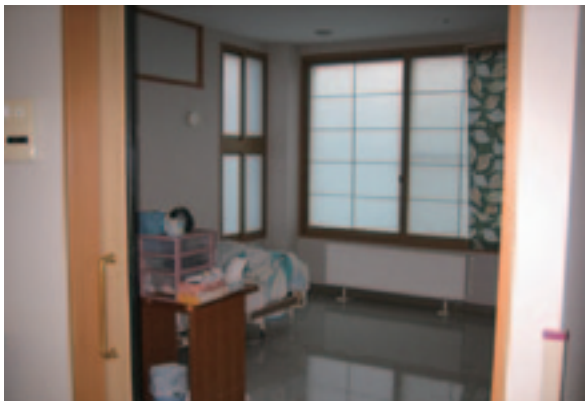
エコキュートを利用した居室内の温水パネル
