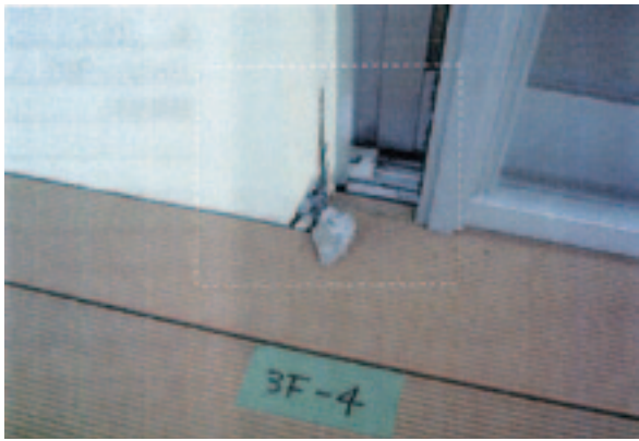
外壁被害状況1 ※
