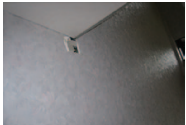
天井と壁の取り合いの破損
