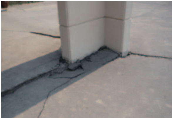
建物に損傷はなかったが、外部と建物の接点で、断裂 ※
