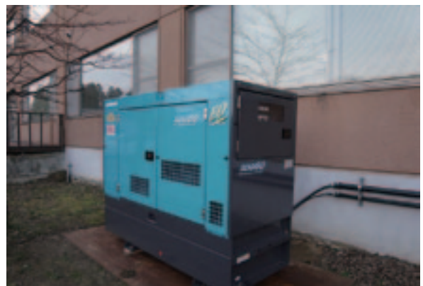
震災後設置された発電機
