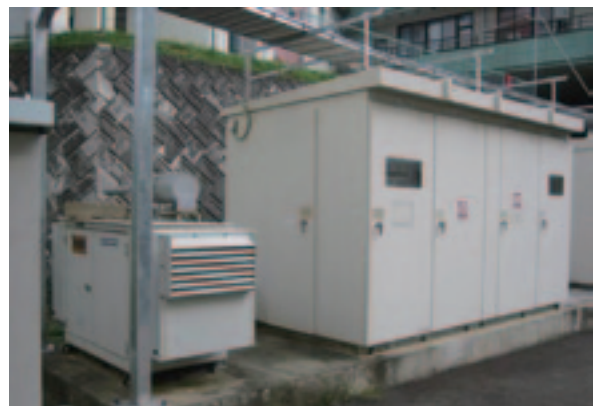
発電機（定格出力 21KVA）とキュービクル
