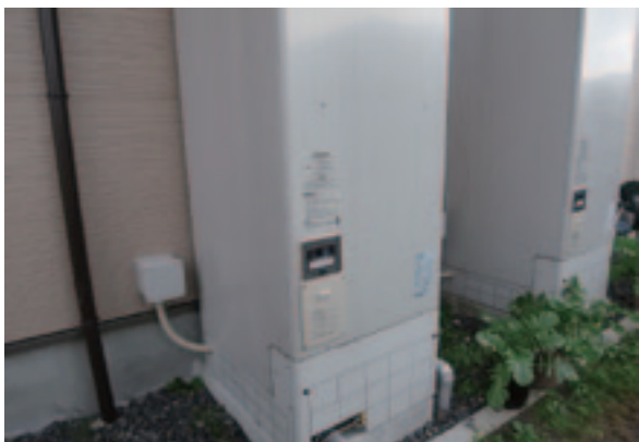
屋外給湯器：一台は揺れて傾いて断線
