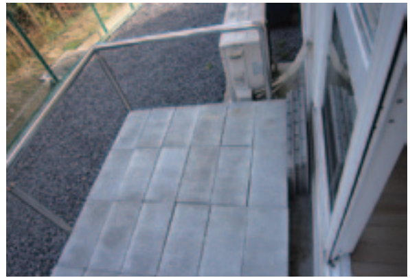
裏口 地面が傾き隙間が生じる
