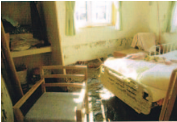
被災直後の状況 居室 ※
