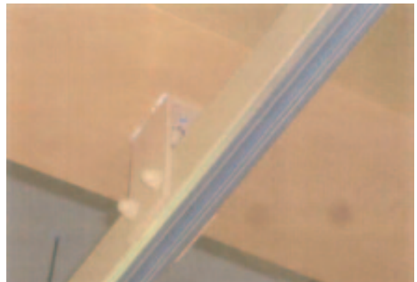
舞台上 天吊り金具のねじ抜け
