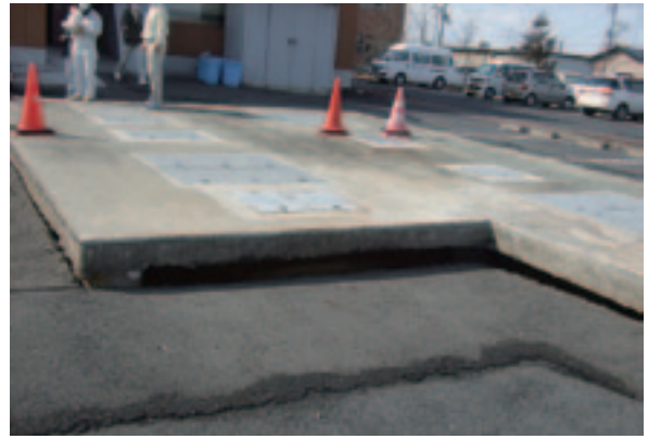
敷地内での地盤被害
