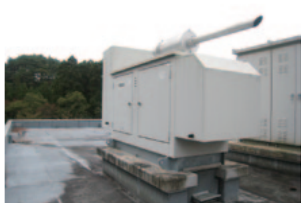
発電機 屋上に設置（スプリンクラー用）
