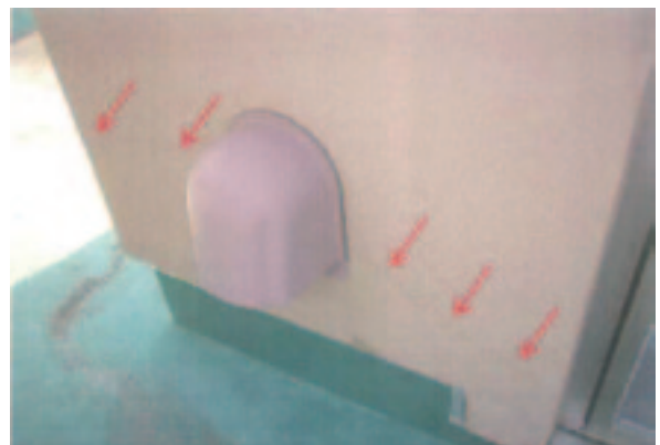
屋上外壁の亀裂
