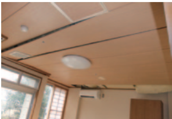
新棟での天井落下被害 ※
