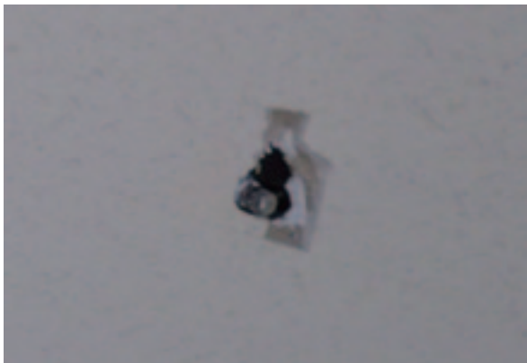
スプリンクラーの破損※
