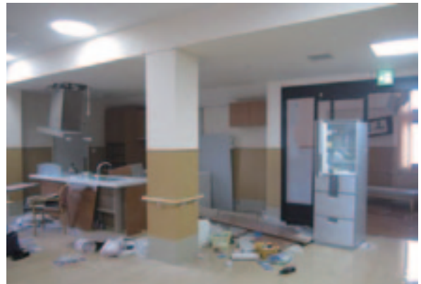
ユニットのキッチン キッチン、換気扇等が破損 ※
