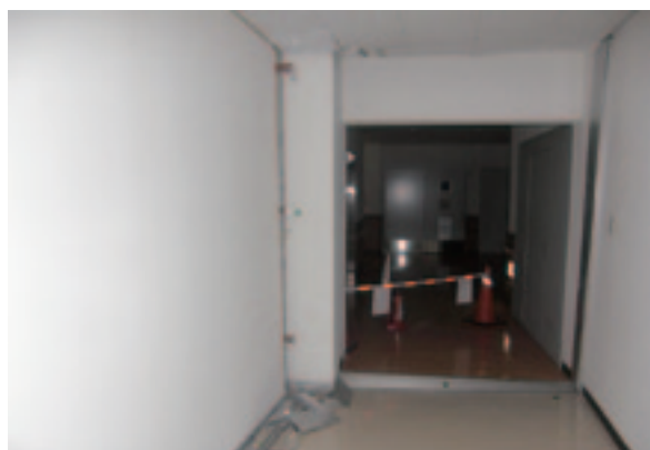
施設を結ぶ通路（エキスパンションジョイントがずれている）
