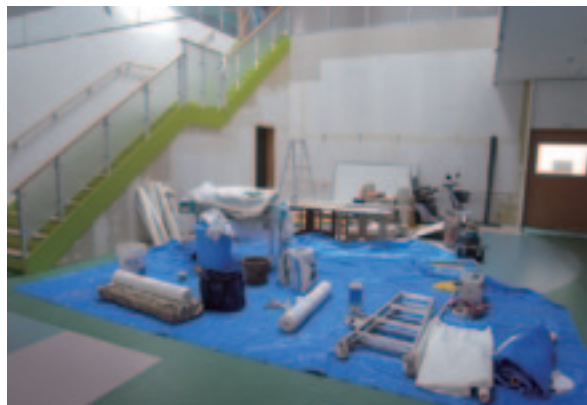
スプリンクラー配管破損により放水、水浸しとなり使用不能
