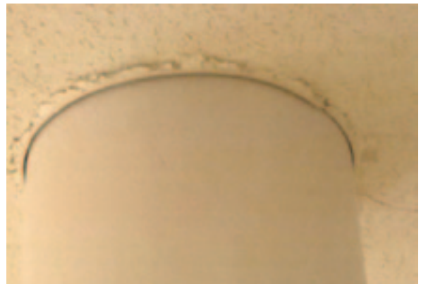
ホールの円柱 天井材との取りつき部分が破壊 ※
