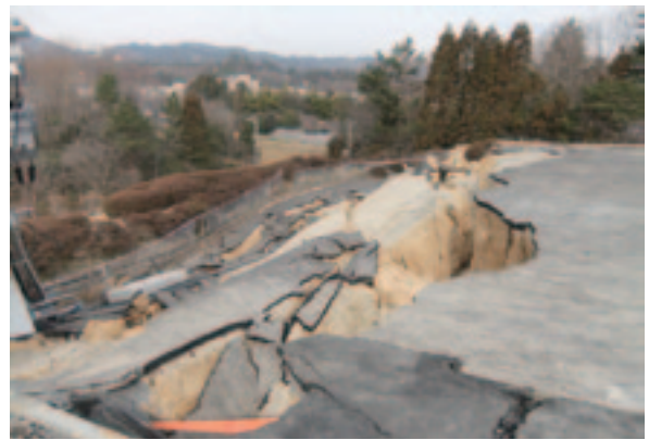
地盤崩落により下の道路もふさがれる ※
