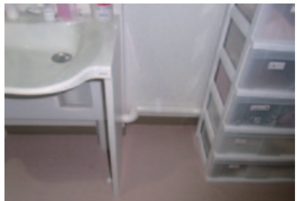
居室の下水管 引きなし
