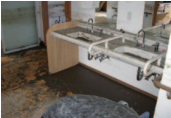
建物内の浸水被害1 ※
