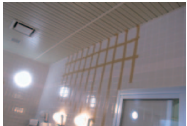
浴室 タイルの亀裂。ガムテープで応急処置 ※
