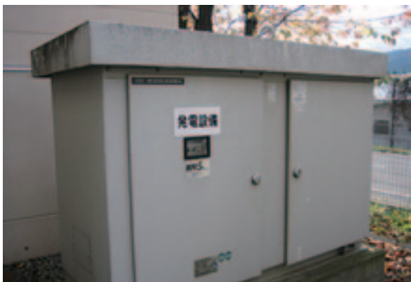
発電機（定格出力 60KVA）
