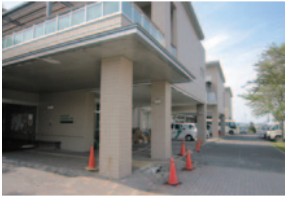
施設入口 亀裂が生じる
