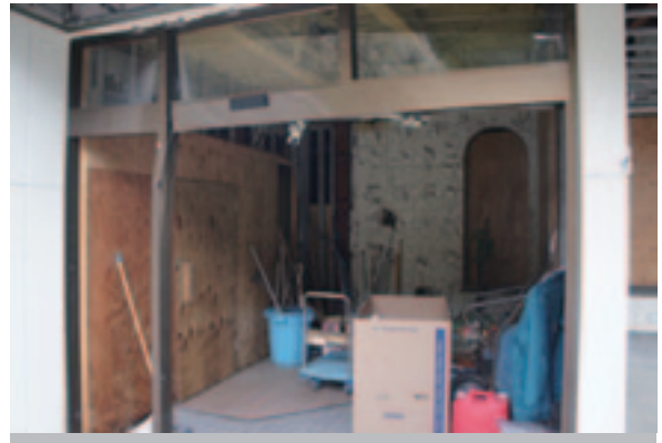
玄関 津波が開口部を貫き支柱が曲がる
