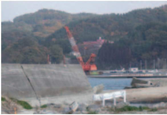
外観 海に面した高台に位置する。手前は決壊した防潮堤
