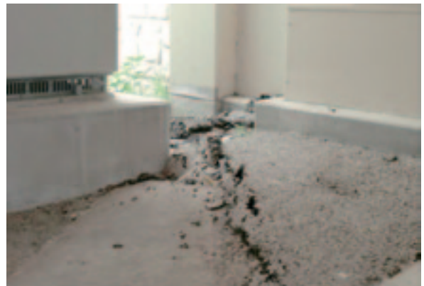
キュービクル部分の地盤沈下 ※
