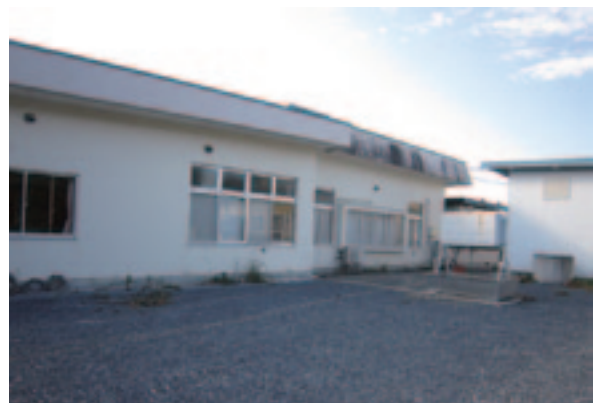
隣接するデイサービス 左側に建物が傾斜する
