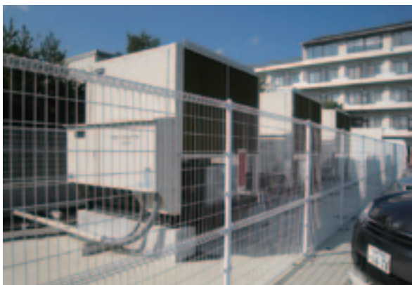
蓄熱システム
