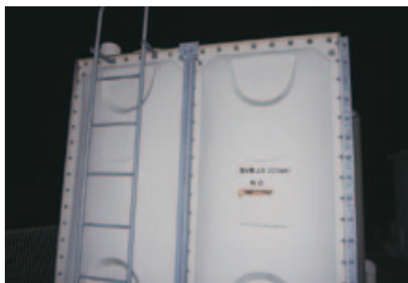
水道用受水槽
