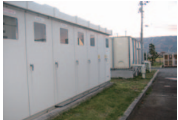
受変電設備 地上設置型
