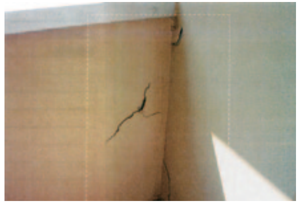
外壁被害状況2 ※
