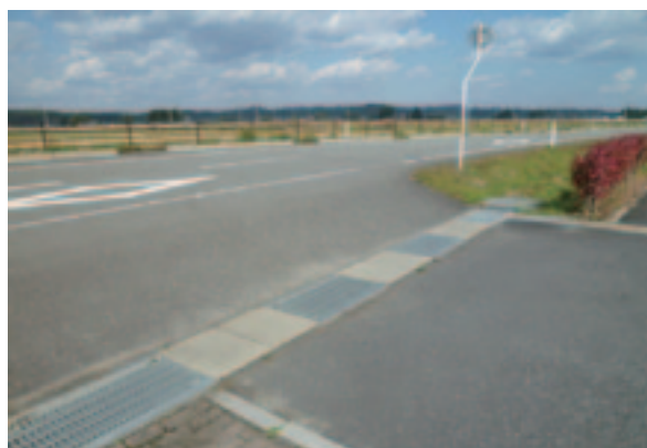
舗装面が若干沈下 ほとんど気にならない
