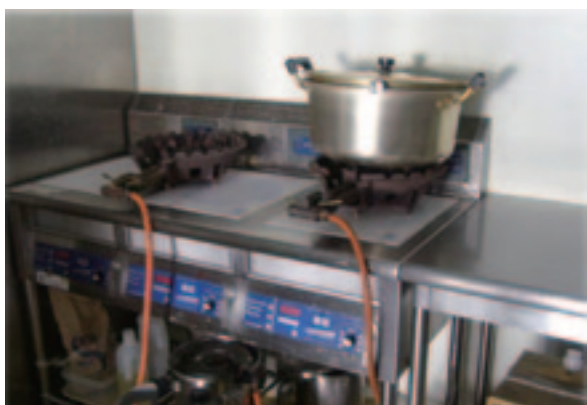
オール電化厨房にガスコンロを設置し調理 ガスはプロパンボンベから直結 ※
