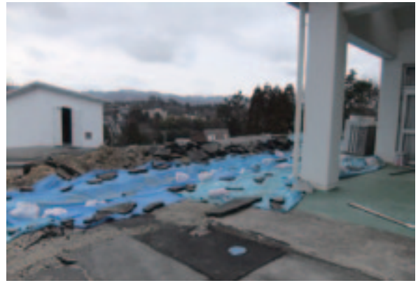
敷地内の地盤被害 ※
