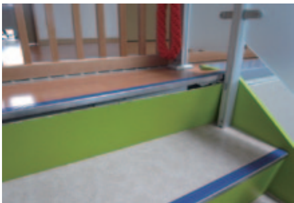
階段部分の破損
