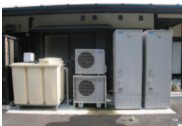
給湯設備、スプリンクラー用の貯水槽
