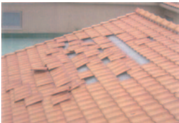
屋根瓦の破損
