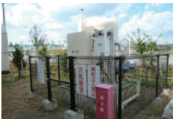
自家発電装置 非常用のため油がすぐになくなった
