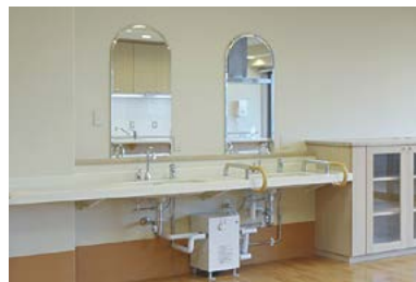
第二万寿苑： 局所給湯器を備えた洗面台
