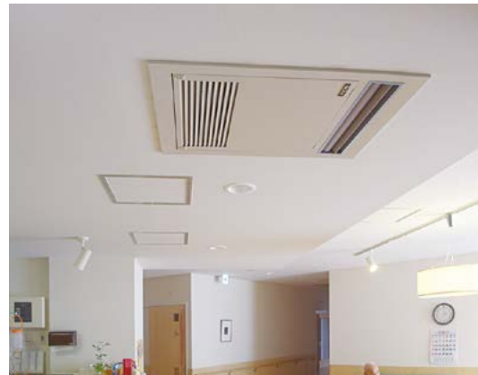
共同生活室の空調設備
