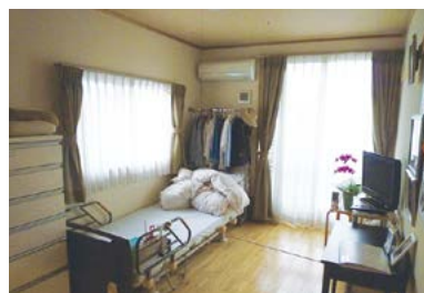
あいあいの郷： 居室エアコンと壁に設置された給気口
